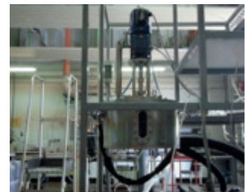
Station pilote de digestion anaérobie pour le traitement des margines
