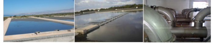
معالجة مياه الصرف البلدية في المحطة التجريبية الثالثة في أغادير - المغرب: (أ) المعالجة الأولية؛ حوض لاهوائي للمعالجة الأولية؛ (ب) المعالجة الثانوية؛ مرشح رملي؛ (ج) منظومة تعقيم بالأشعة فوق البنفسجية - المعالجة الثلاثية.
